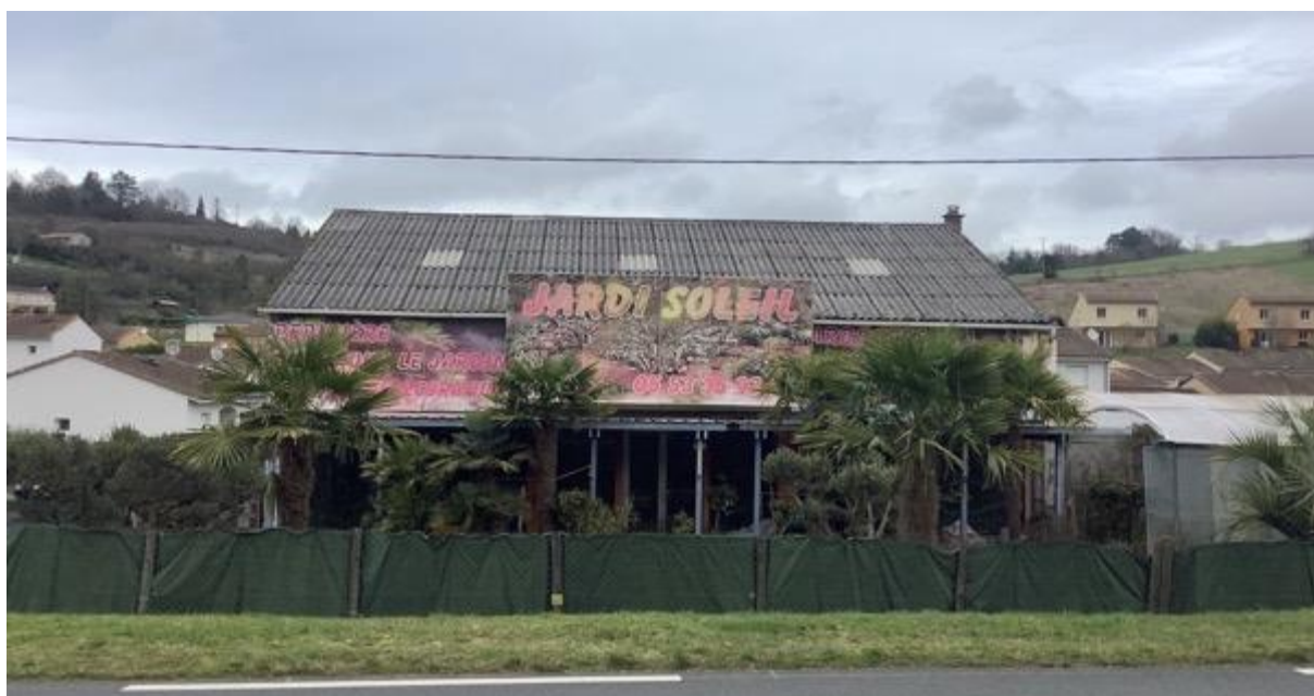
Enseigne sur toiture avec un panneau de fond (non conforme), Sanilhac, février 2021
